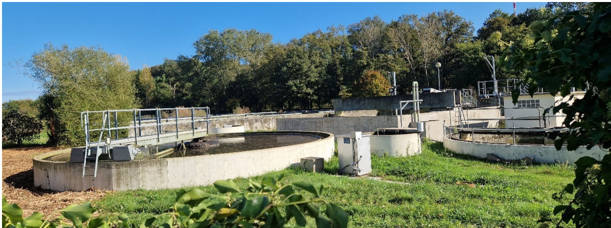
Figure 147 - La station d'épuration de Traînou (Terr&Am, octobre 2024)
